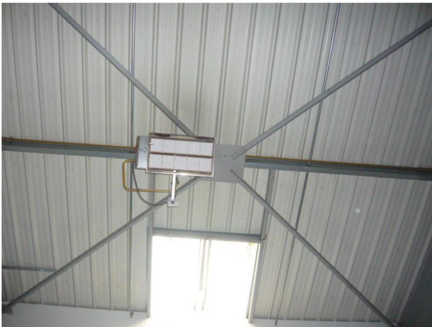
Chauffage électrique du ocal
